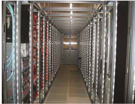
Figure 5.22 : exemple de configuration couloir froid
