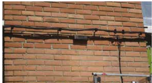
Figure 4.17 : câble optique en façade
