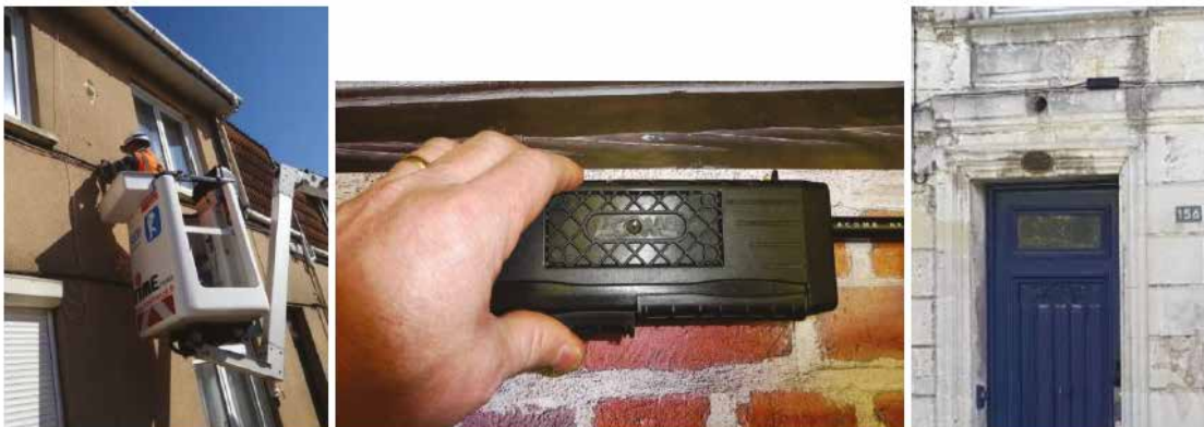
Figure 4.49 : points de branchement optique façade
