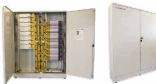
Figure 4.43 : exemple d'un répartiteur SRO/PM
