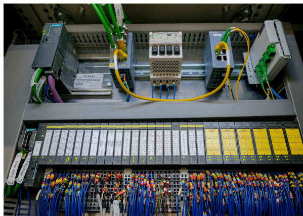
Raccordement optique d'un automate machine.
