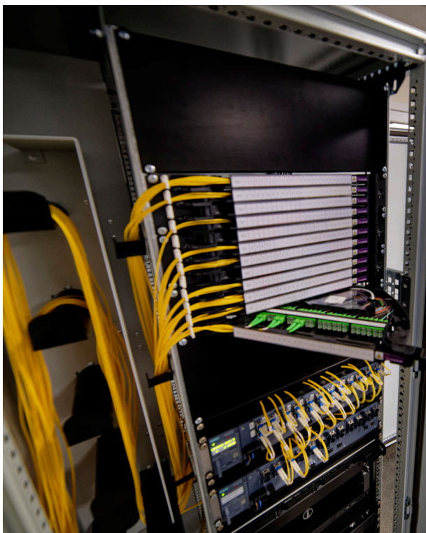
Baie de brassage HEMERA d'où partent les câbles PACe vers les machines.
